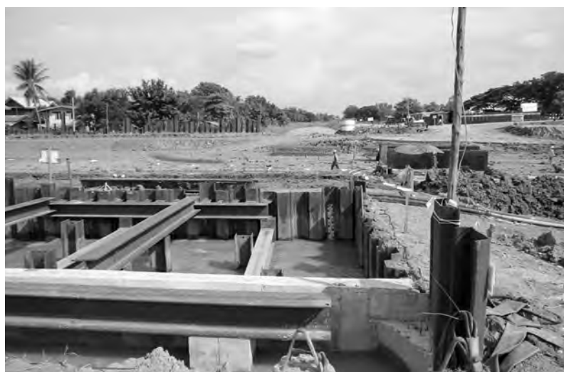
チャオプラヤ川沿いバンチョームシー水門の改修現場。2011年大洪水による破壊の後、全面的に設計を見直した再建工事が進められている(2012年9月20日撮影)
