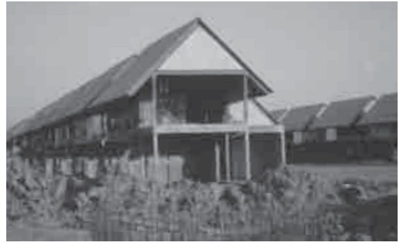
写真1-5-6 2階の床梁が屋根梁より幅がある
