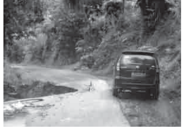
写真1-1-3 降水による土砂崩れで路肩が割れた道路
