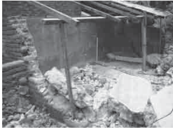
地震によって壊れた貯水槽。生活用水をまかなっていた
