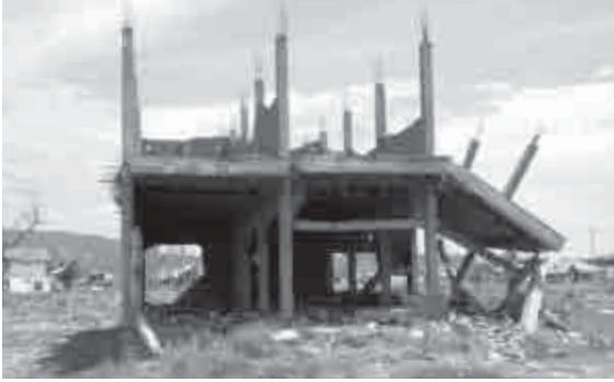
写真1-5-1 建築中に被災した建物。途中までレンガが積まれている
