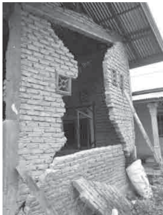
写真1-2-1 パダンパリアマンの被害家屋。斜めに亀裂が入って崩壊している
