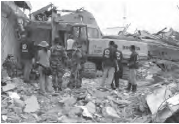
写真3-2 ビルの倒壊現場で行われる救出作業（パダン市内）
