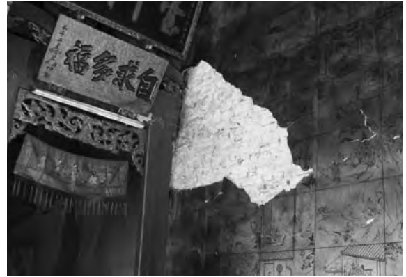
カンブン・チナ（華人居住区）地区の廟。地震のために壁画の一部が崩れ落ちた。
